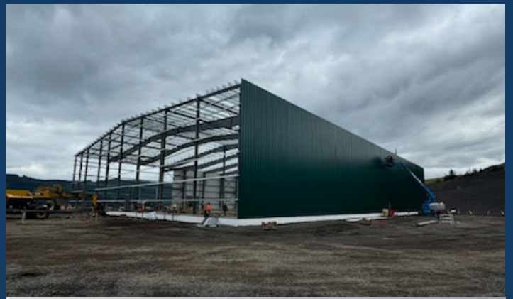
STATION DE TRAITEMENT DES EAUX – CONUMA COAL
