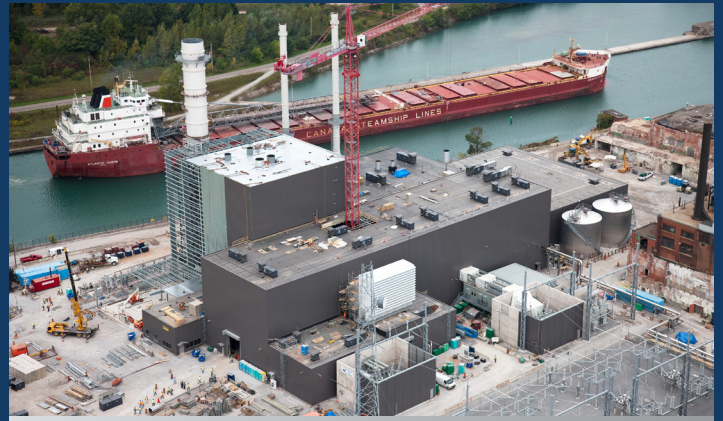
CENTRALE DE COGÉNÉRATION DE THOROLD, ALIMENTÉE AU GAZ NATUREL
